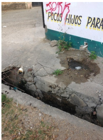
FIGURA 1: Se observa la tubería de PVC saliendo de un domicilio para descargar al canal de riego en la Comunidad de San Sebastián, Etlá, Oaxaca.
