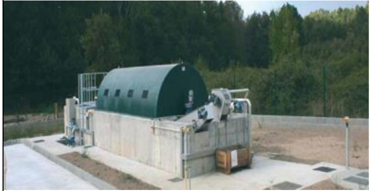
Foto: Planta compacta de tratamiento de aguas residuales. Fuente: Sande y Díaz, 2014
