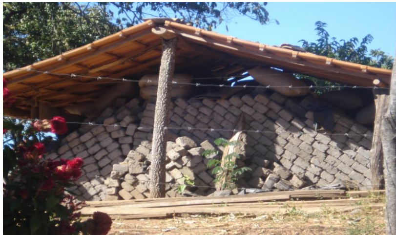
FIGURA 3. Adobe acondicionado: Valdirene Gomes dos Santos de Jesus, 2008.
