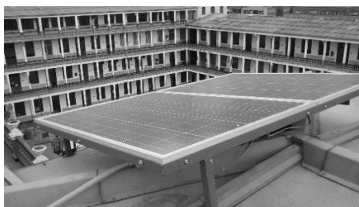
FIGURA 2. Foto de los paneles solares del sistema solar evaluado. Fuente: Autores
